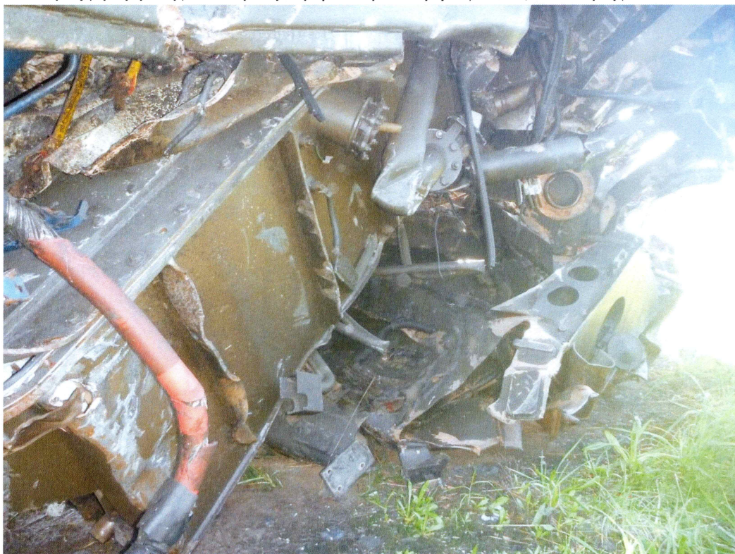
Λεπτομέρεια κάτω μέρους, εμφανής ο Μ/Σ. Κάποιες ενδείξεις καύσεως επί των μεταλλικών επιφανειών (χαμηλά) χωρίς χαρ/κα μεγάλης έντασης / βιαιότητας καύσης
