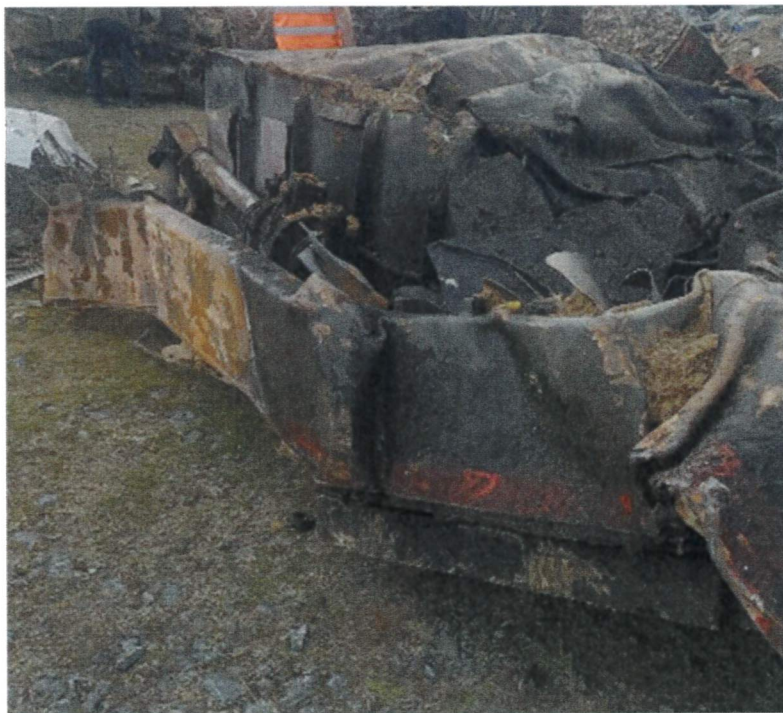
Εικόνα 22: Πλευρά του μετασχηματιστή απέναντι από το σημείο της έκρηξης και την οπή της φωτιάς (απόσπασμα από αρχείο : 20230307_124.106.jpg)
