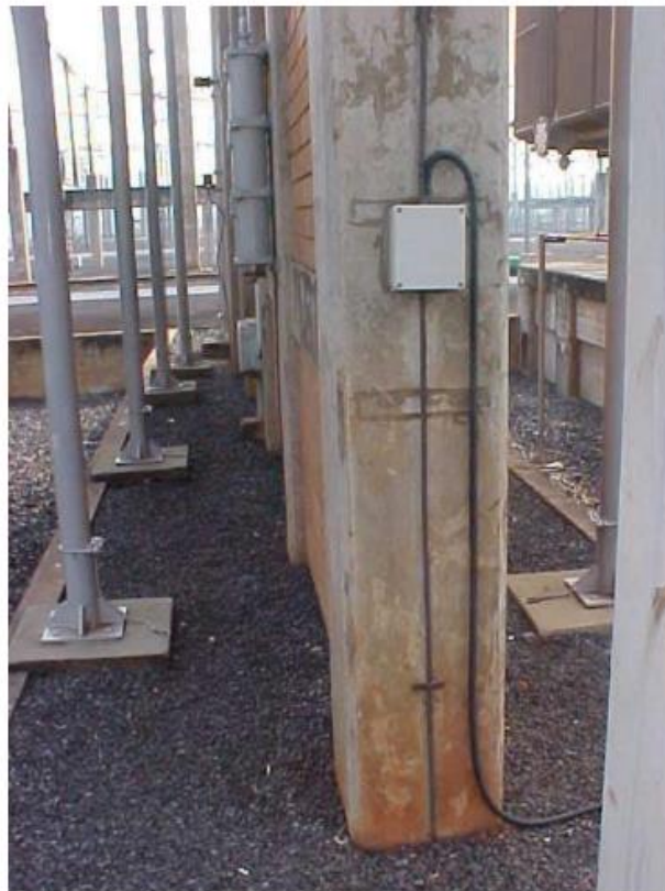
Εικόνα 7. Αισθητήρας SIC IMC Hall τοποθετημένος στο καλώδιο γείωσης [32].
