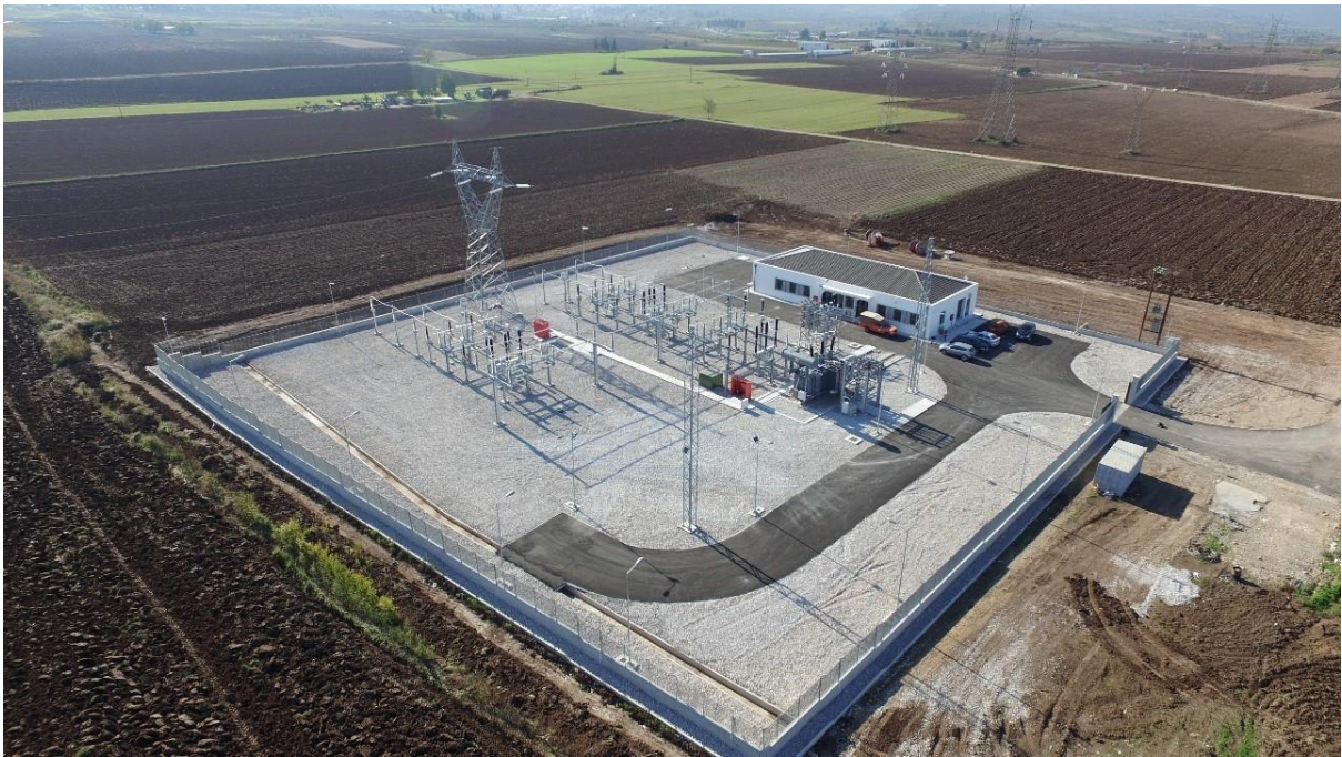
Εικόνα 4: Πανοραμική Άποψη Υποσταθμού Ανύψωσης Τάσης.
